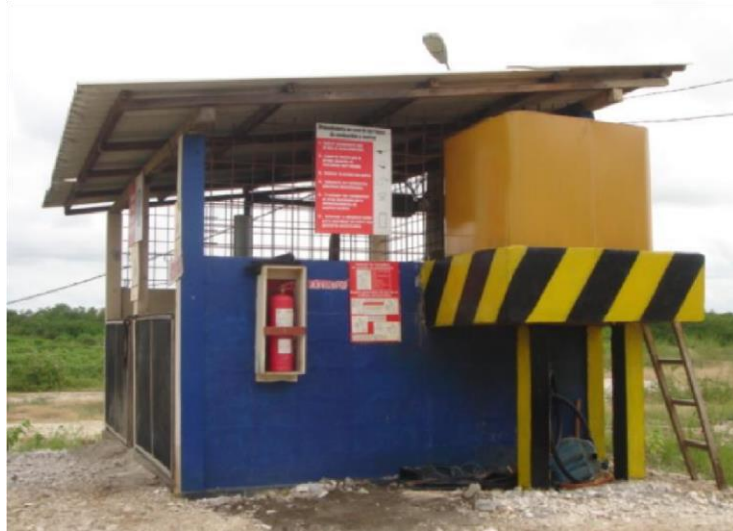
Fotografía No. 41: Área de Generadores.
