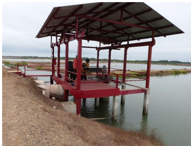
Fotografía No. 50: Estaciones de Re bombeo
