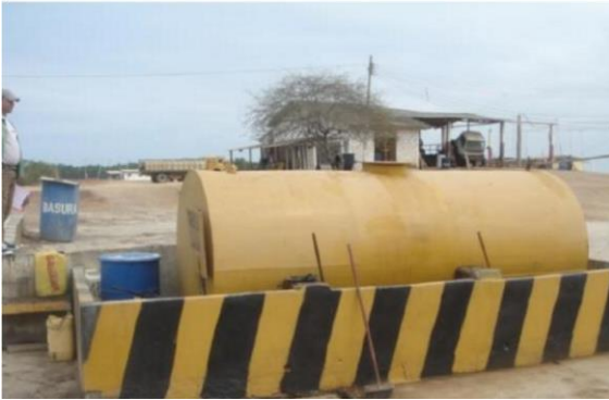
Fotografía No. 51: TK de almacenamiento 1
