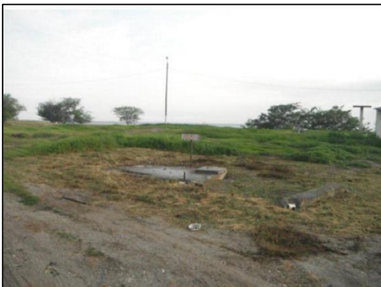
Fotografía No. 46: Pozo séptico 1
