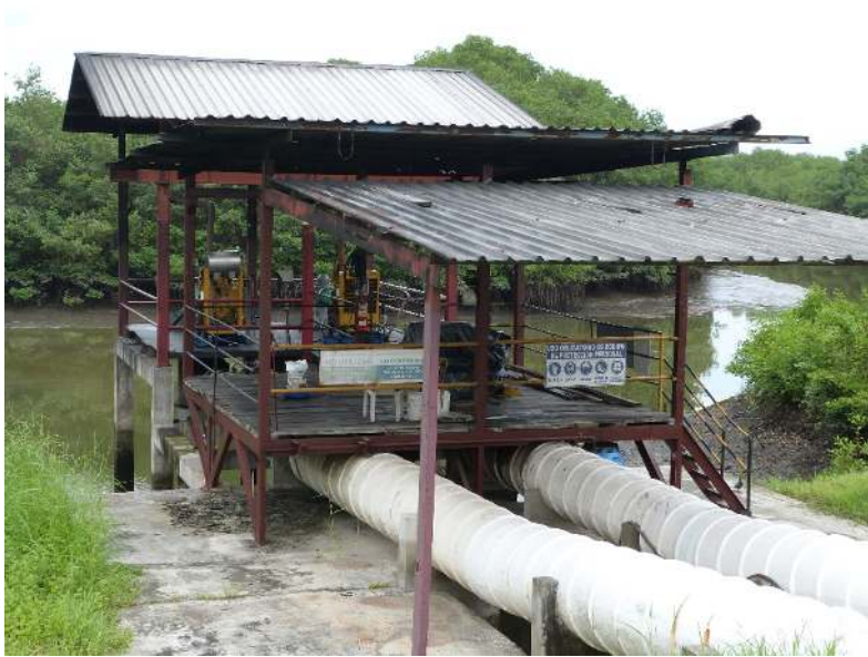
Fotografía No. 61: Estación de bombeo LA ESPERANZA. 2° 19' 23.79" - 80° 00' 24.98"
