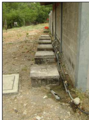
Fotografía No. 56: Sistema de drenaje de aguas residuales domésticas
