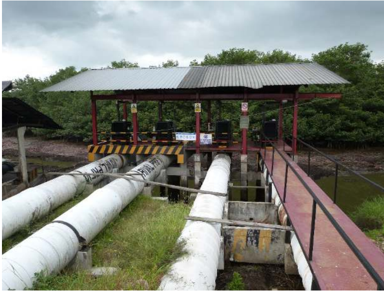
Fotografía No. 62: Estación de bombeo LANGUA. 2° 19' 18.08" - 80° 00' 04.91"
