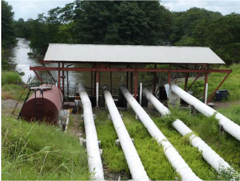
Fotografía No. 58: Estación de bombeo San Rafael. 2° 15' 31.38" - 80° 02' 9.15"
