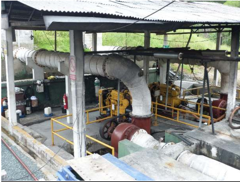
Fotografía No. 60: Estación de bombeo ALGARROBO. 2° 16' 41.74" - 80° 01' 02.13"
