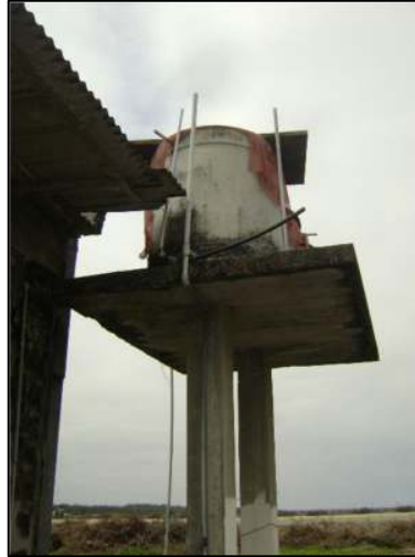
Fotografía No. 54: Tanque elevado de 500 ltrs.
