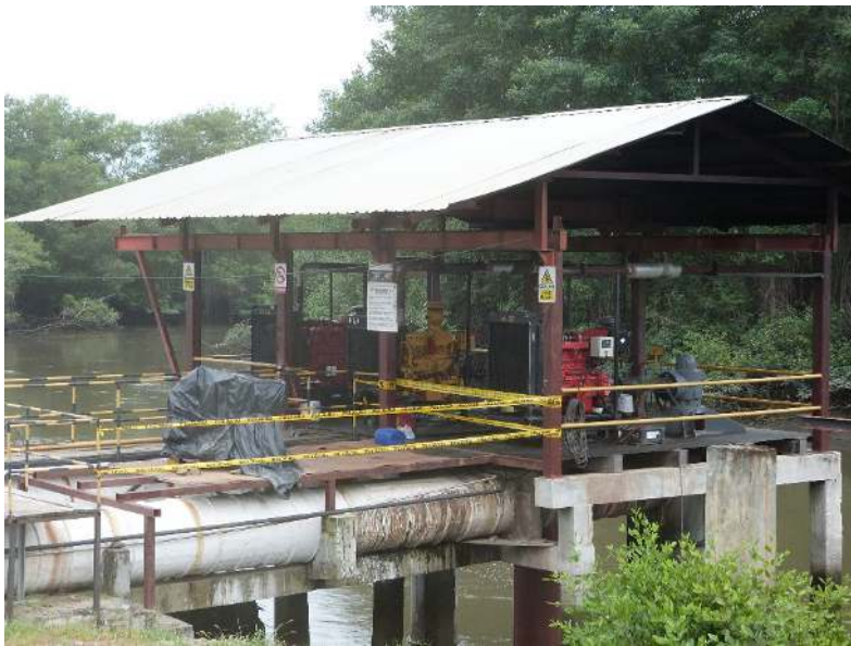
Fotografía No. 59: Estación de bombeo VIGSA. 2° 16' 01.44" - 80° 01' 26.73"
